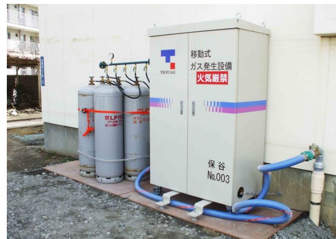
▲東日本大震災後、石巻市内の県営住宅に設置された移動式ガス発生設備(30m³タイプ) 23
