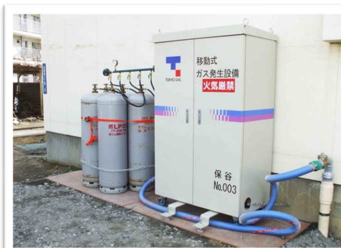
▲東日本大震災後、石巻市内の県営住宅に設置された移動式ガス発生設備(30m³タイプ)
